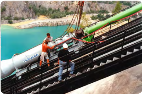
Wülfrath, Alemania: Instalación inclinada de nuestras bombas sumergibles, utilizadas para la extracción de piedra caliza.
